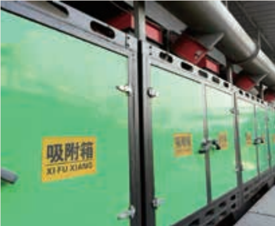
东滩煤矿升级 VOCs 治理设施
